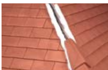
Après coupe des tuiles d'approche, mise en œuvre des arêtiers angulaires petit modèle sans emboîtement, utilisation de mortier (D.T.U. 40.23. art 3.4).
