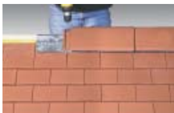
Après mise en place du closoir ventilé, les faitières sont vissées dans la lisse de rehausse.
