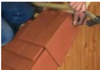
Mise en œuvre des rives individuelles gauches et droites, posées un rang sur deux et fixées par clou.
